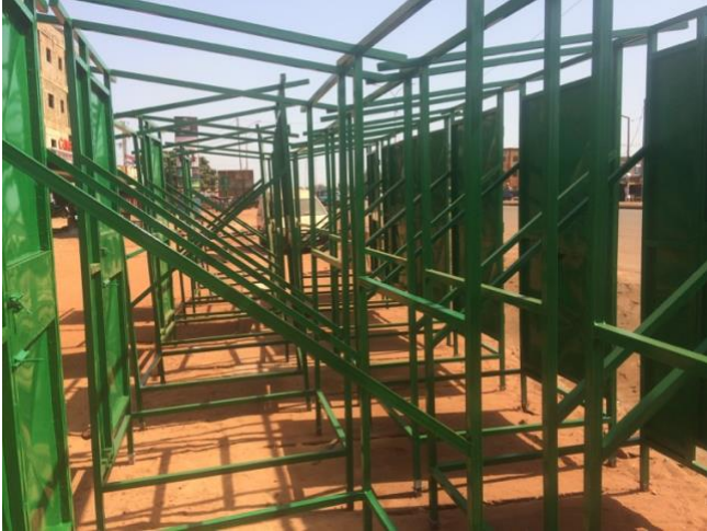
Structure ferronnée des latrines
